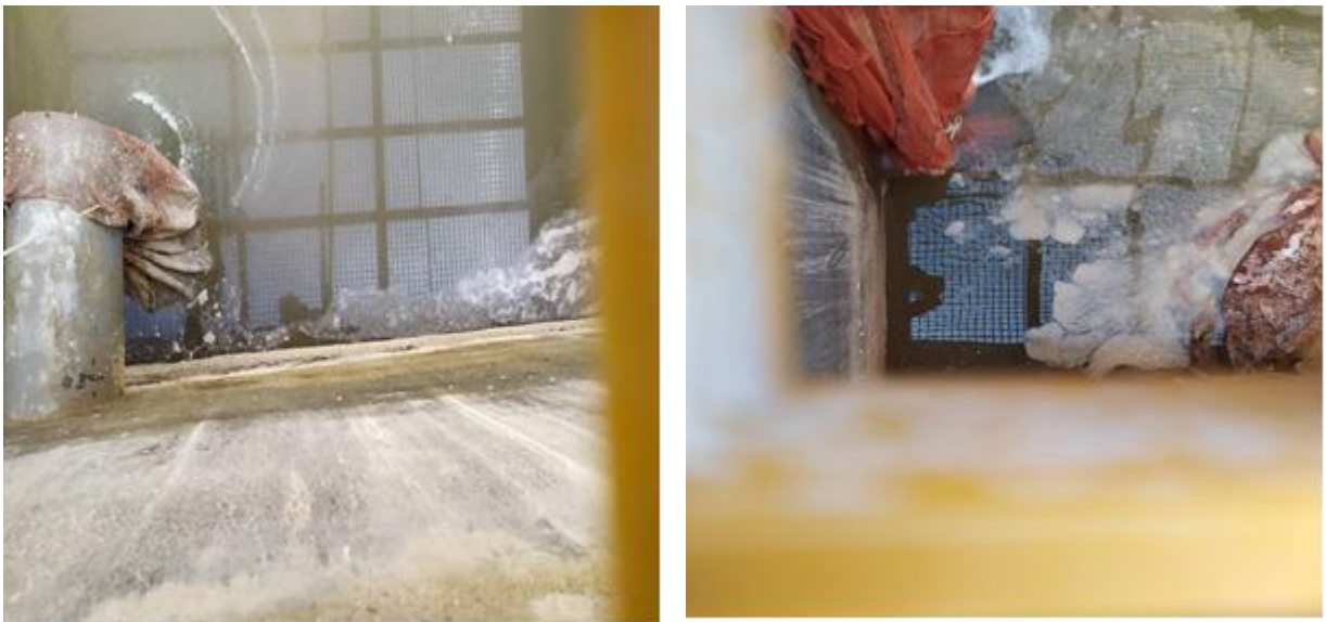
Hình 3. 12 : Bể 1 – Xử lý Chlorine 30ppm
