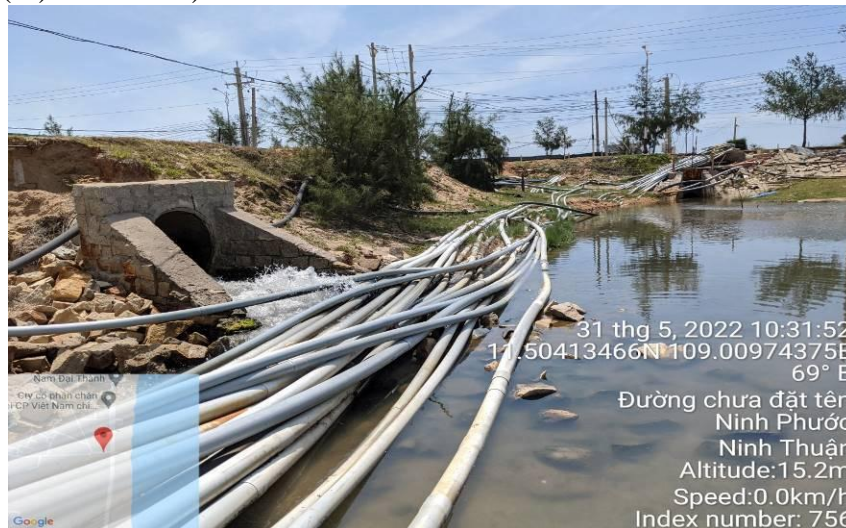
Hình 3. 7 : Khu xả thải tập trung xã An Hải
