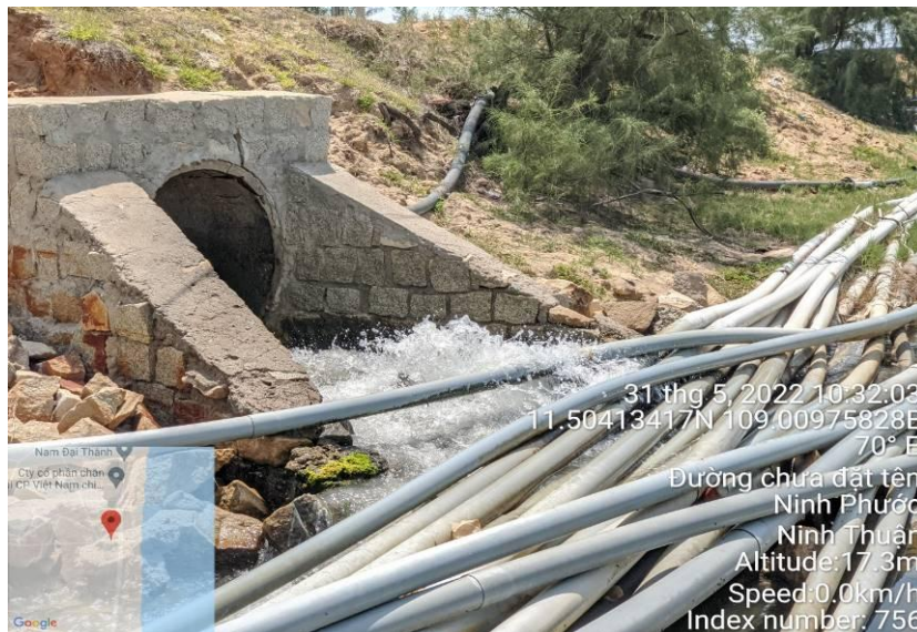
Hình 3. 14 Khu xả thải tập trung xã An Hải
